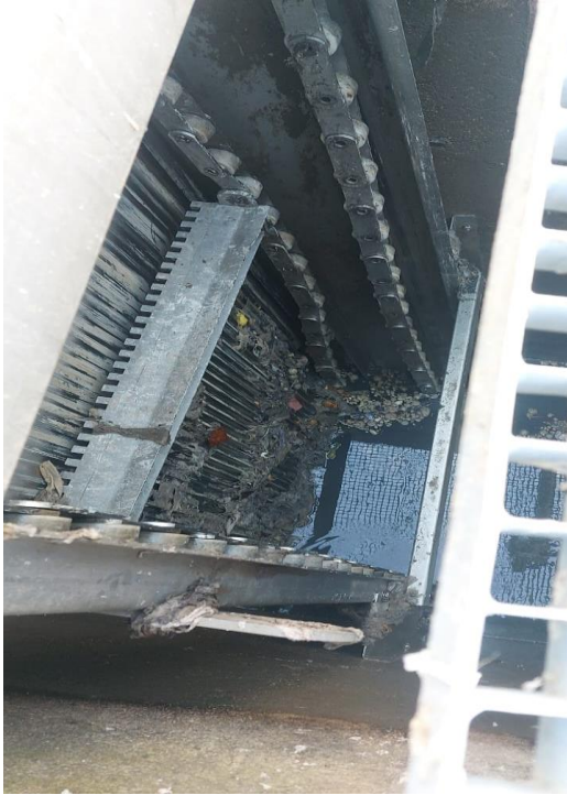
Slika: Havarija na ulaznoj gruboj rešetki
