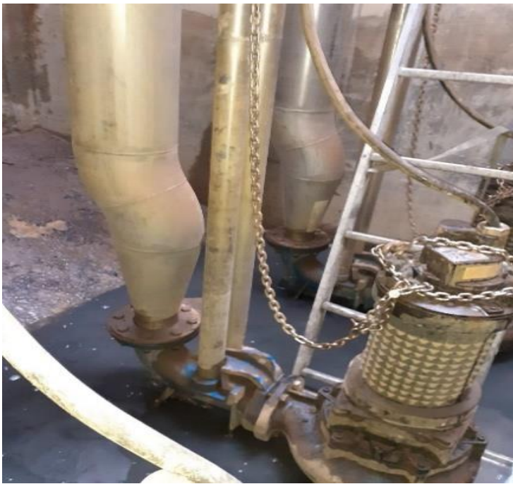
Slika: Ulazna CS sa novim muljnim pumpama
