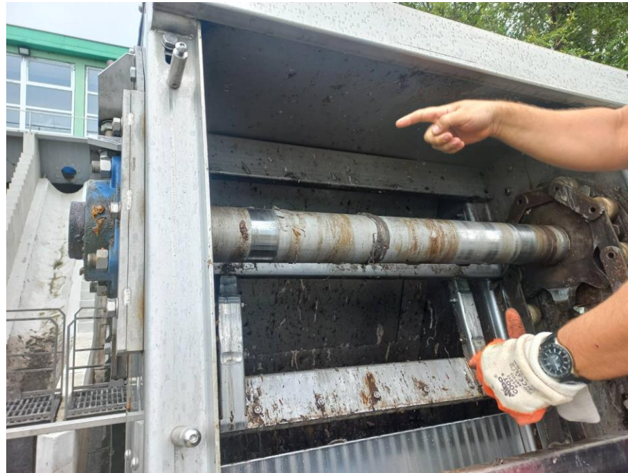
Slika: Havarija na ulaznoj gruboj rešetki
